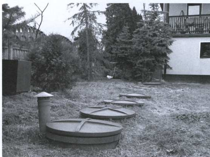
Przydomowa oczyszczalnia ścieków
